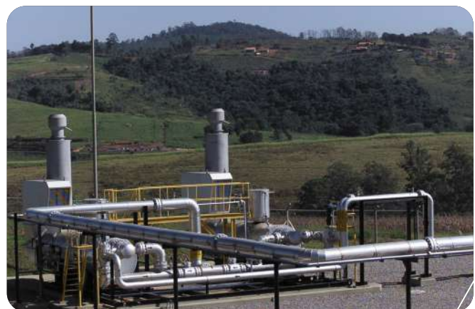
Tubulações que trazem o gás do gasoduto Brasil-Bolívia, em Itatiba. São Paulo, 2019.
